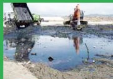
災害流入土砂・津波堆積物
