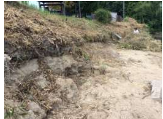
上流堤体法面の浸食
