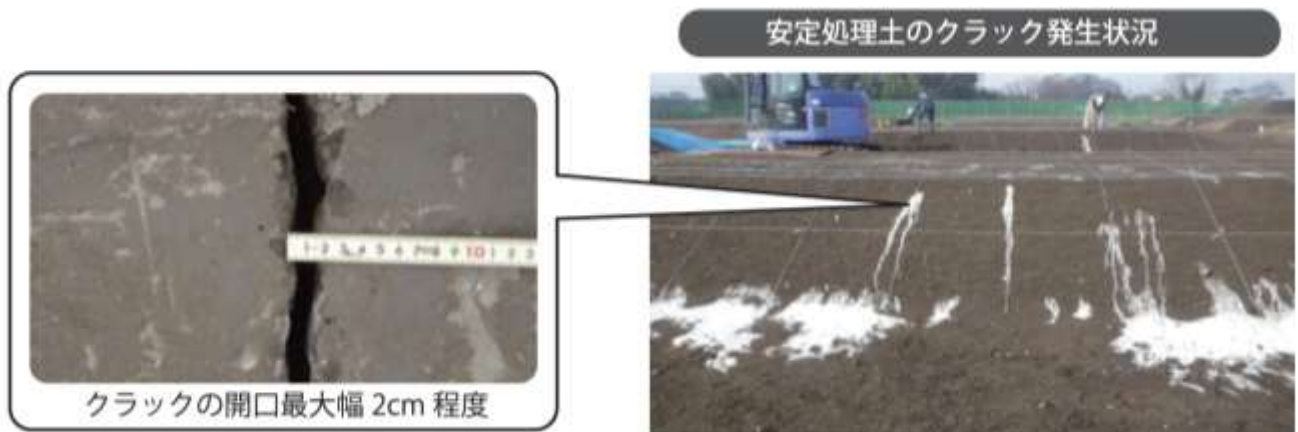
図-9 安定処理土のクラック発生状況
