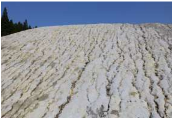
山砂による高速道路路肩盛土のガリ浸食
