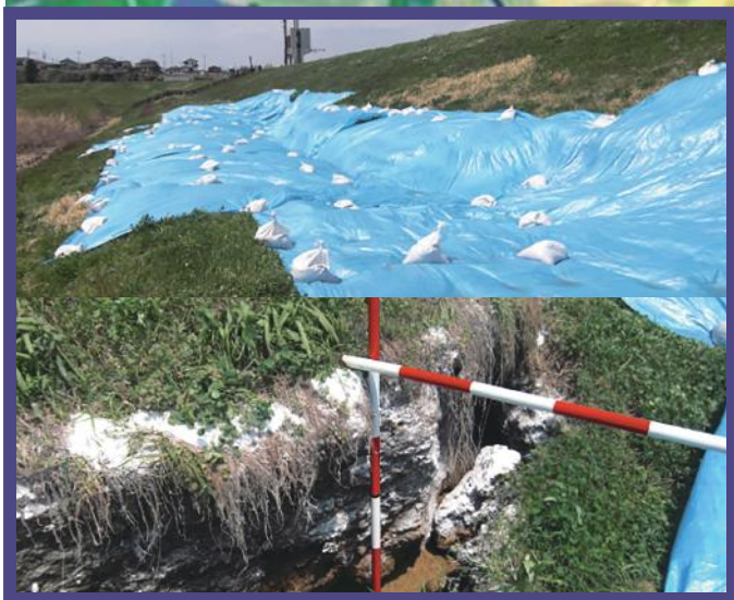
【震災後、掘削土・購入土を用いた施工箇所】 液状化によるせん断破壊を確認
