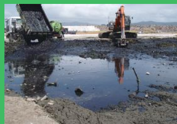
災害流入土砂・津波堆積物
