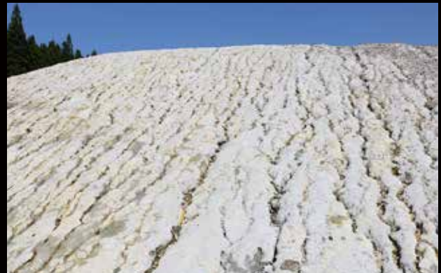
安定処理土 ガリ侵食多数
